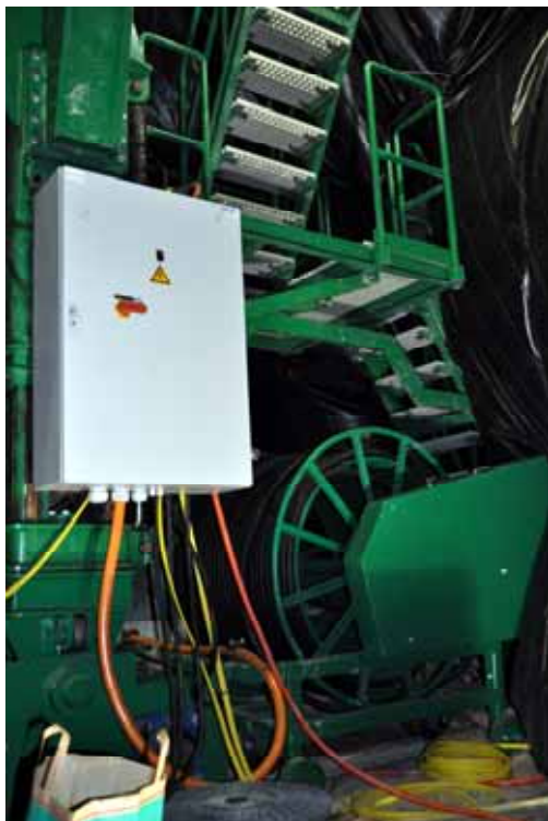
Ansicht der im Schalungswagen integrierten Motorleitungstrommel
