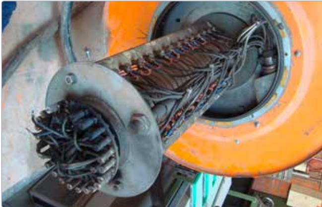
Alter Schleifringkörper (Fremdfabrikat, keine Ersatzteile mehr)
