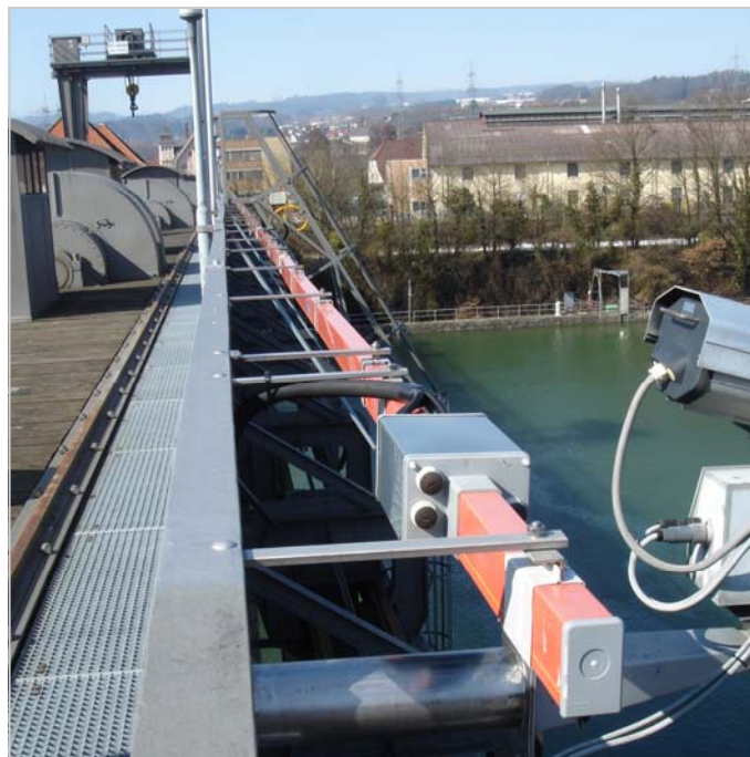
Flusskraftwerk Rhein Krananlage eingespiessen mit Akapp RN7, mit Heizband und Dichtlippe (gegen aufsteigende Feuchtigkeit)
