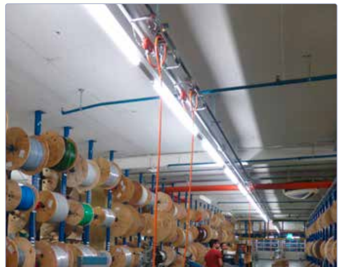
Stinger-System, Schleifleitung in Kombination mit Kabelwagenanlage für Kabelabläng-Maschinen
